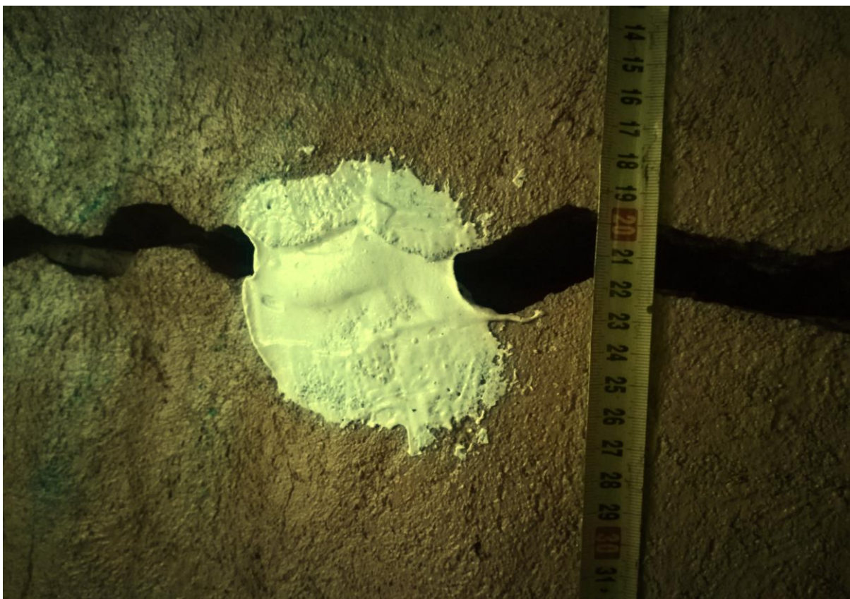
Foto 4: Sádrový terč v místě největšího rozevření trhliny v jižní stěně (21 mm)
