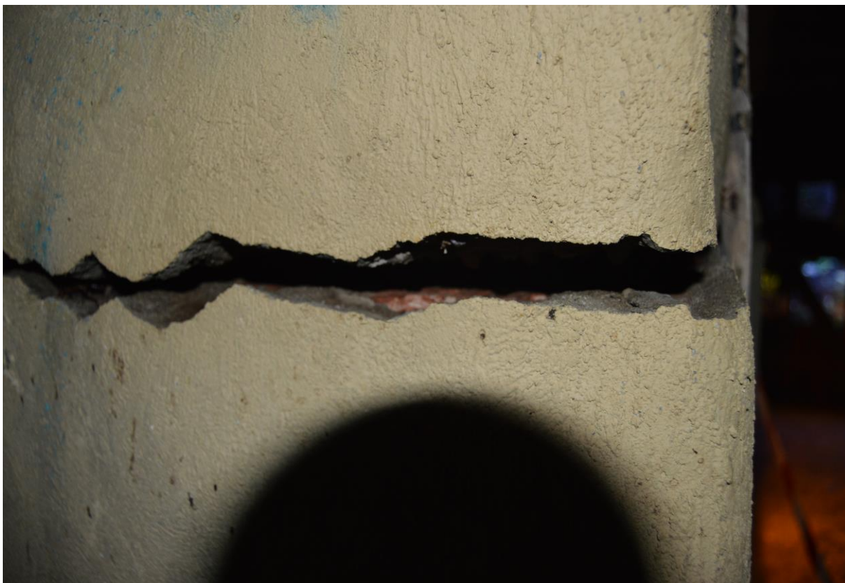
Foto 5: Detail největšího rozevření trhlinky – jižní stěna TH Vestavku
