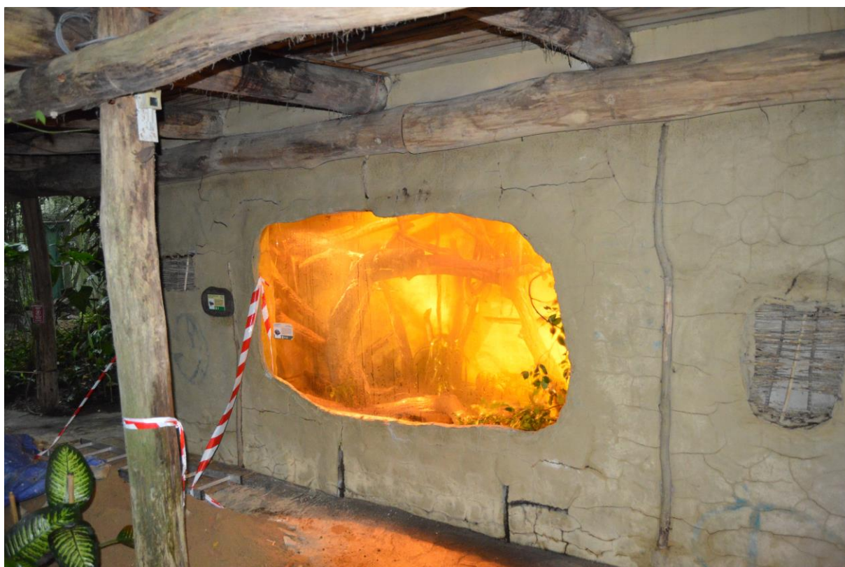
Foto 2: Pohled na východní průčelí TH vestavku - skleněná výplň okna terária
