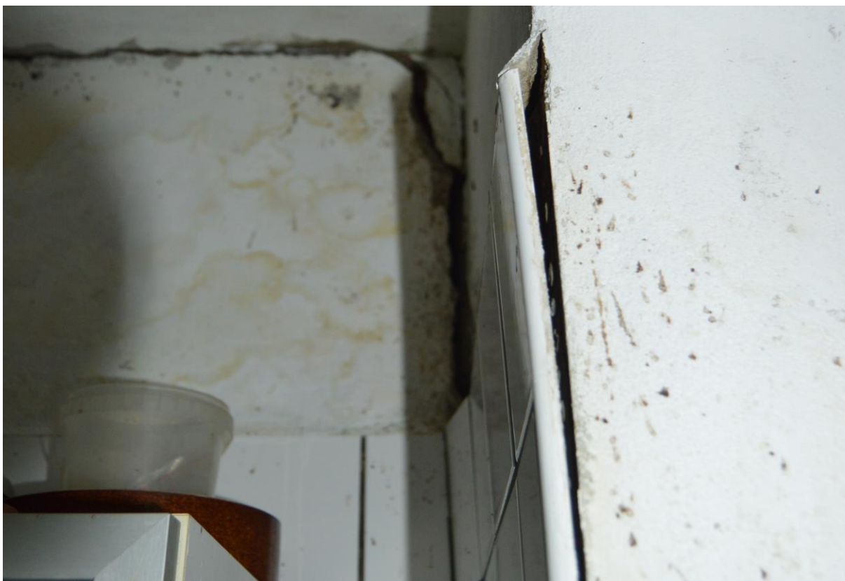
Foto 9: Oddělení bělinového obkladu na vnitřní straně jižní stěny TH vestavku
