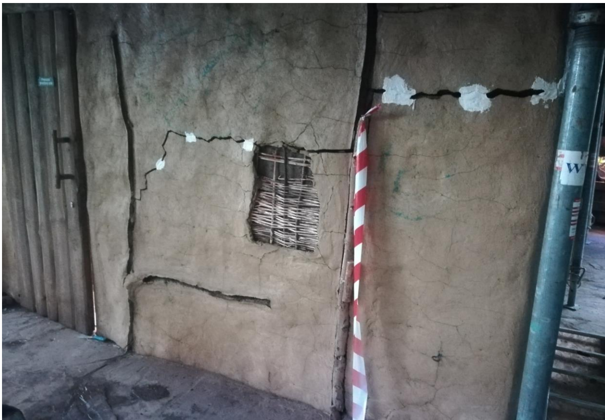
Foto 3: Osazení sádrových terčů na trhlině v jižní stěně
